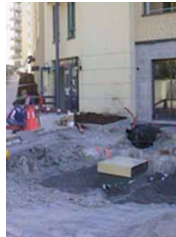
Gassanlegg i boligsameie
