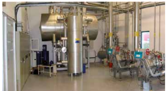
Eksempel på et kuldeanleggs maskinrom
