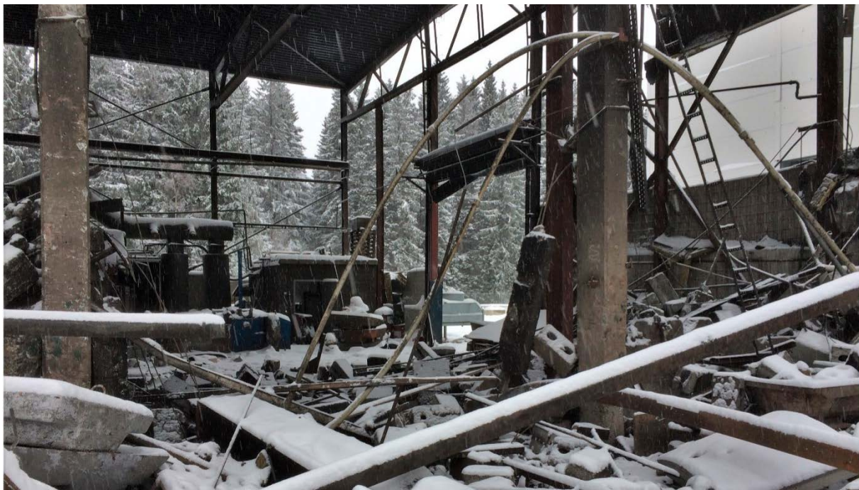
FIGUR 4. Skadeomfang etter eksplosjon i en smelteovn hos Metallco. Foto: DSB.
