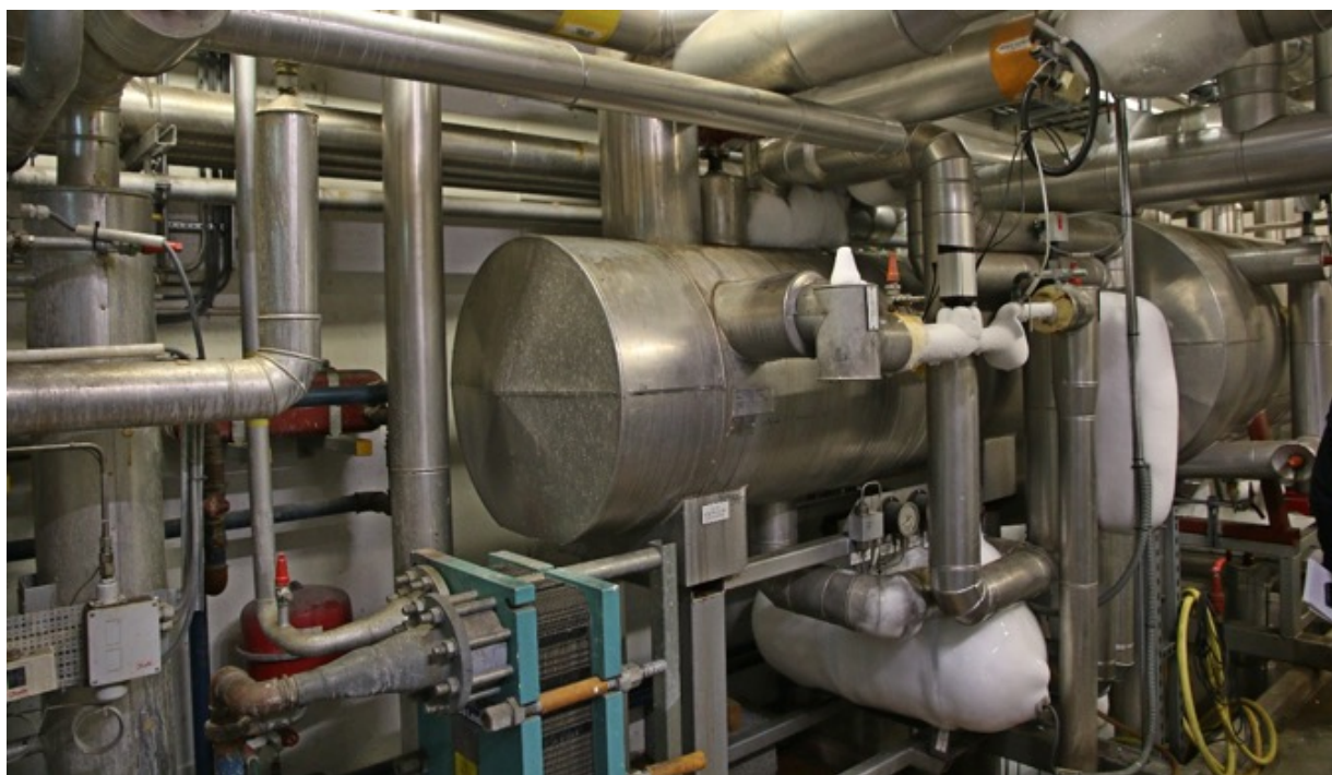
Maskinrom med kuldeanlegg. Det normalt med ising der det er lav temperatur.
