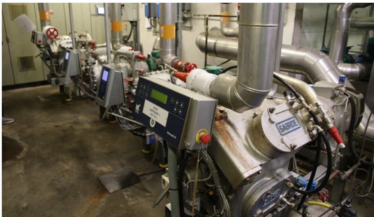
Kompressorene til kuldeanlegget
