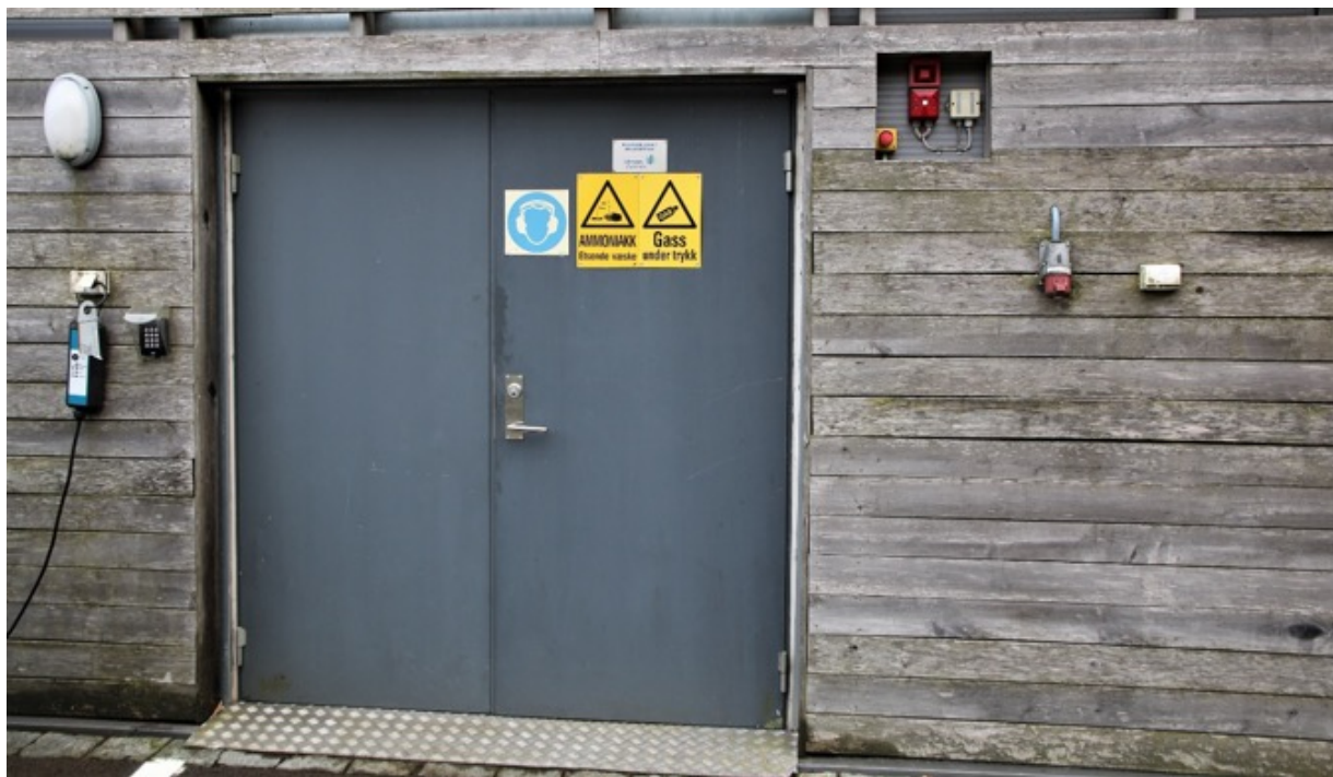
Skilting, lyd- og lysalarm på utsiden av maskinrom for et kuldeanlegg.
