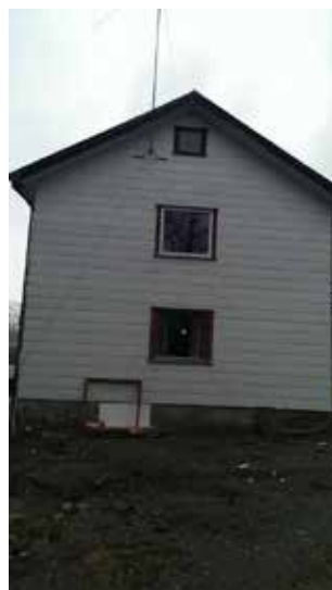
Østvegg. Ett av to vindu knust. (Blåst ut?)
