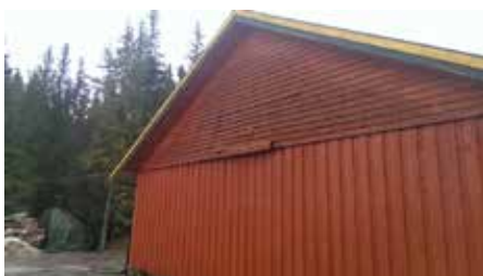
Fasade mot vest. Vegg buler.
