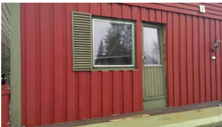
Vestside. Dør presset inn.
