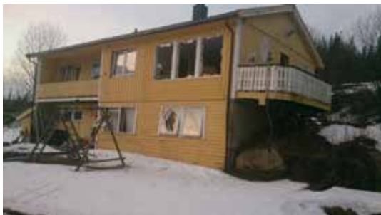
Langside mot sør. Vinduer knust. Vinduer skjøvet inn.
