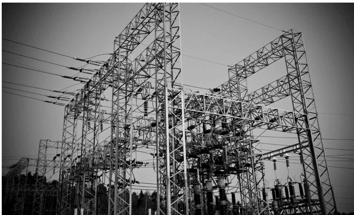
Trafostasjon ved Abildsø, Oslo. Foto: Espen Bratlie/Samfoto.
