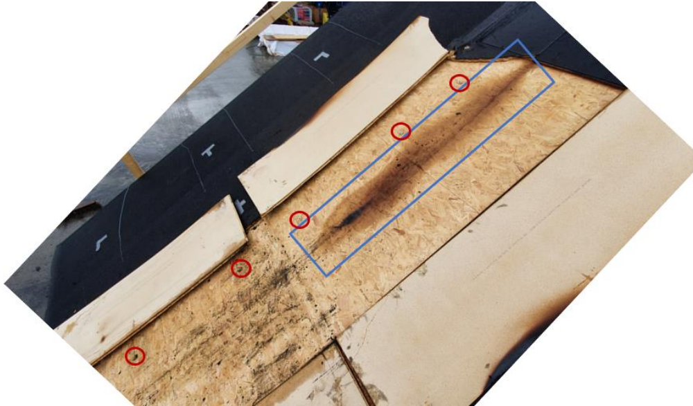
Figur 3-16 Svimerker på OSB-plate etter forsøk F1. Svimerket er lokalisert under skøyten av sponplatene omkring 30 cm til høyre for senter av forsøksoppsettet (markert med blå firkant). Målepunkta under sponplata langs senterlina er vist med raude sirklar.
