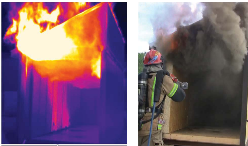
Figur B-12 Test 3B – Brannscenario før start sløkking. IR kamera viser godt at det brenner inne i veggen , mens det på ekte er svært vanskelig å se.
