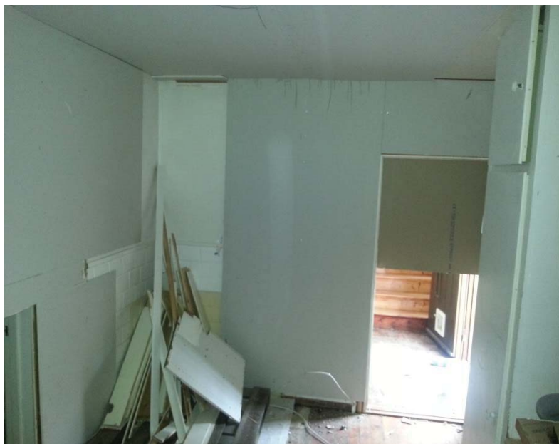
Figur A-1 Bilde som viser forsøksrom 1. I hjørnet er plankehaugen som blir brukt til antenning av rommet og den halve døren står åpen under hele forsøket. Foto: Rune Larsen.
