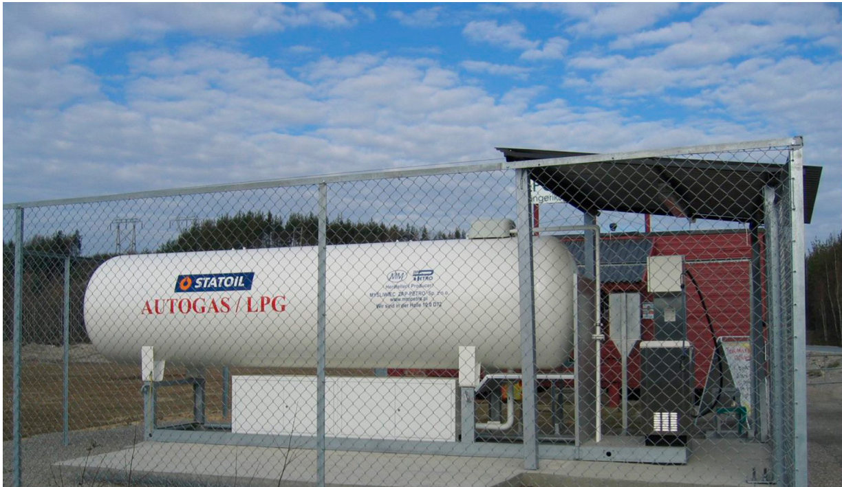
Tank med LPG (Foto: DSB).
