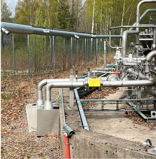
Hovedstengeventil ved avsenderanlegg (Foto: DSB).
