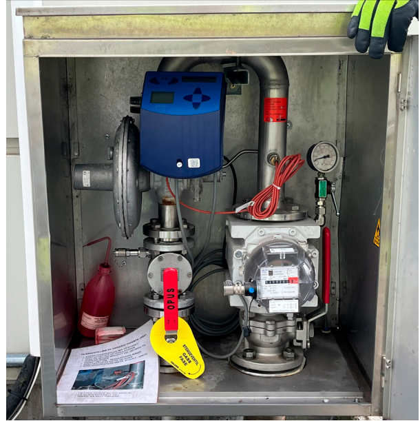
Inntakskabinett ved forbruker (Foto: DSB).
