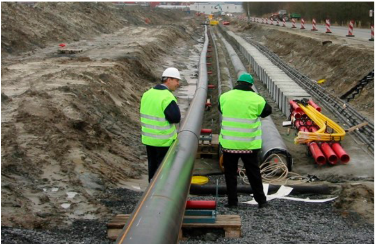
Rørledning for naturgass. (Foto: Lyse Neo AS).
