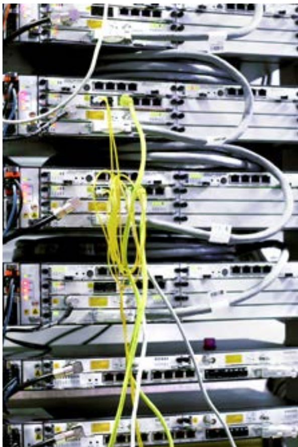
Telekom-utstyr hos mobiloperatør. Foto: Colourbox.
