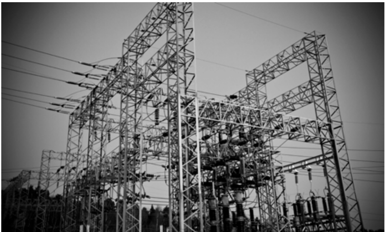
Trafostasjon ved Abildsø, Oslo. Foto: Espen Bratlie/Samfoto.
