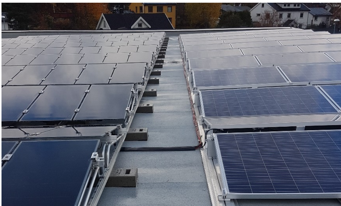
Figur A-2 To ulike typer solceller på taket av Kiwi Dalgård i Trondheim. Tynnfilmsolceller til venstre og krystallinske solceller til høyre. Foto: RISE Fire Research.
