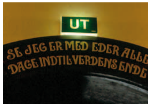
Eksempel på uheldig merking av rømningsvei
