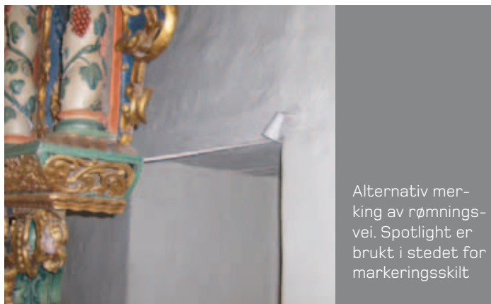
Alternativ merking av rømningsvei. Spotlight er brukt i stedet for markeringskilt.
