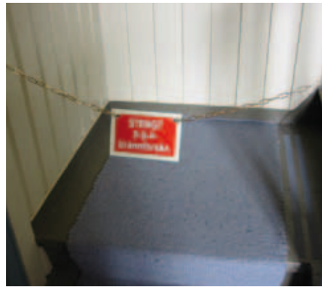
Trappen til galleriet er stengt fordi brannsikkerheten ikke er ivarettatt
