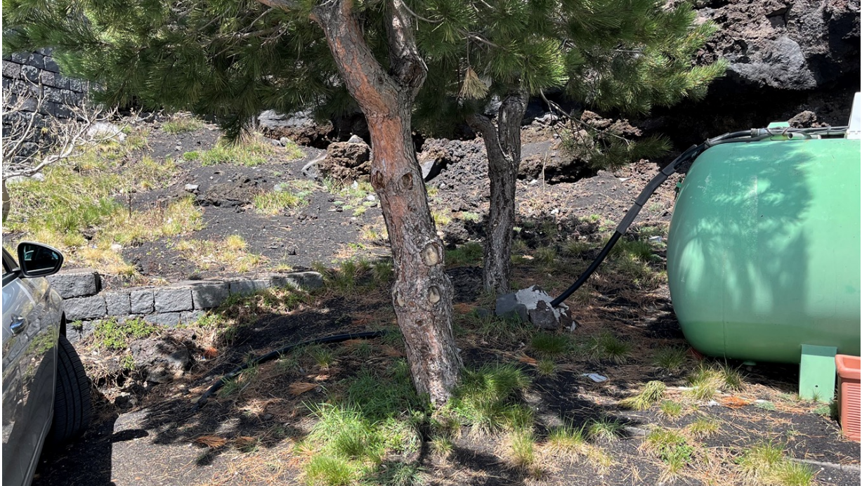
FIGUR 4. Gummislange fra LPG-tank på parkeringsplass. Eksempel på bruk av gummislange som ikke er i henhold til Norsk Gassnorm (Foto: DSB).
